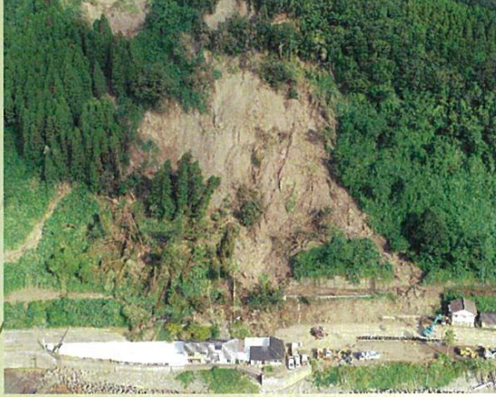
法面崩壊時全景
